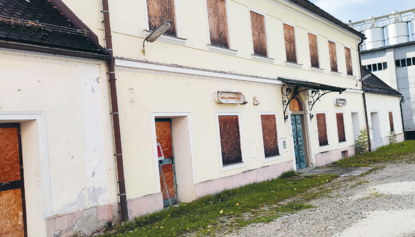
Die Bahnstation Engelhof gilt als ältester Bahnhof am europäischen Festland. Derzeit zeigt er sich in einem desaströsen, baufälligen Zustand.
